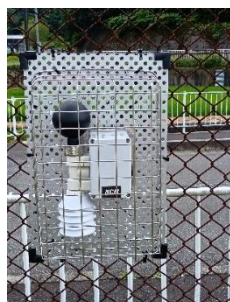
【グラウンド設置センサー】
